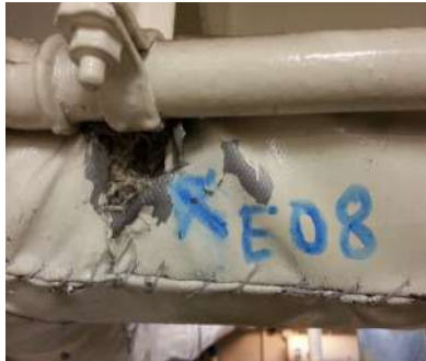
Calorifugeage sur canalisation
