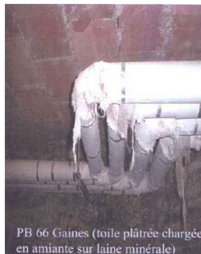
PB 08 Gaine (laine minérale + toile + plâtre chargé avec du chrysotile)
